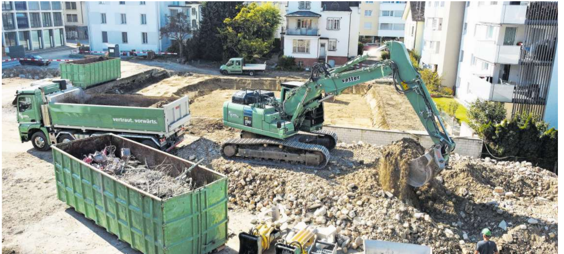
Mit dem Bagger schaufelt Jack Lieberherr den Bauschutt in den LKW. In den Containern sammelt er Recyclingmaterial, daneben liegen die Bagger-Werkzeuge. Bild: Mario Testa
